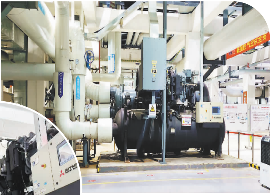
图为南部能源中心制冷主机设备图。
